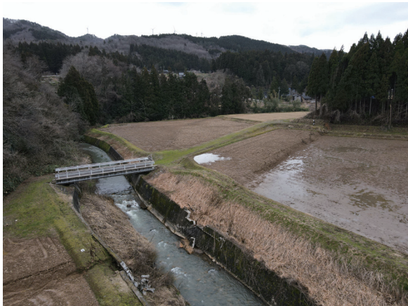
写真5 珠洲市若山町中付近 Loc.1に現れた段丘面の撓曲変形と護岸工の横ずれ変位を伴う変位。
