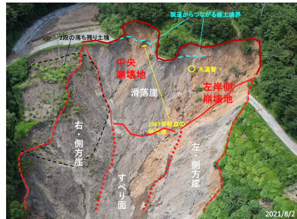
図 13 逢初川崩壊箇所上部の斜め写真（静岡県，2021a：2021 年 8 月 2 日撮影）斜面崩壊の輪郭構造を追記。それ以外の文字・記号は原図中のもの。
