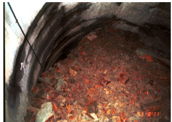
図8 木ノ浦トンネル崩落状況（1993年2月7日能登半島沖地震被害状況報告）。
