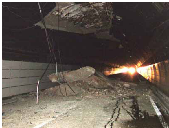
図 11 国道 17 号川口町和南津トンネルコンクリートの剥落（H16.10.24 撮影，国土交通省北陸地方整備局道路部による）。
