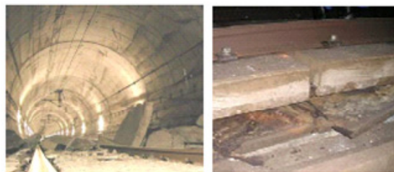
写真-1 魚沼トンネル被害状況
