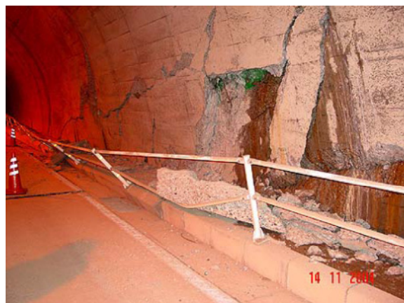
図12 木沢トンネル被害状況（土木学会，2005）。
