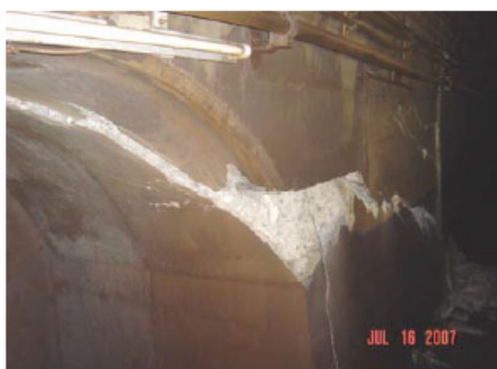
写真 3-3 第一米山トンネル （側壁コンクリート損傷状況）
