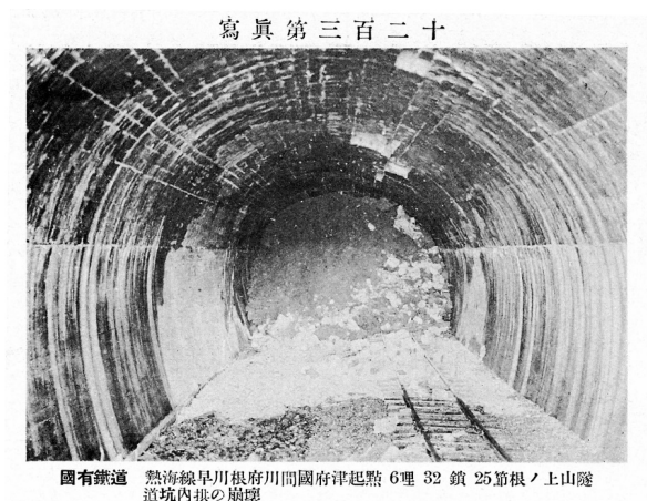
図2 熱海線早川―根府川間の根ノ上山トンネル坑内の崩落 (土木学会 HP)。
