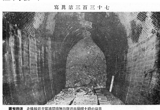
図3 北條線(現在の内房線)岩井―富浦間の南無谷トンネル坑内崩落 (土木学会 HP)。
