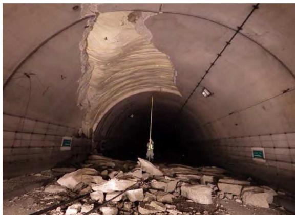
図14 俵山トンネルの被害状況（熊本県HPより）。
