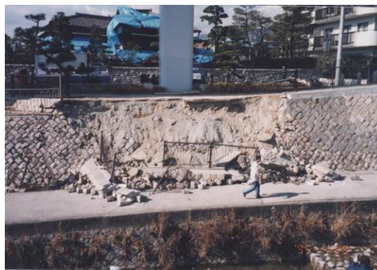
写真15 高速道路のピアの揺れが地盤に伝播し、ピア近傍の石積み擁壁、民家の破壊を大きくした（東灘区魚崎北町4丁目の住吉川沿い）
