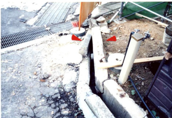
写真9 両側の側壁が傾動した三面張り側溝の事例（芦屋市三条町）
