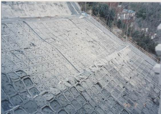
写真 19 斜面の張りブロック法砕工の剥離（神戸市東灘区西岡本） 変形は小段に集中し、そこでは座屈によって山形構造が形成されている。
