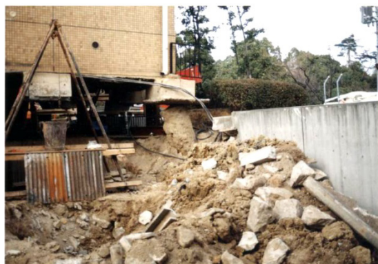
写真 26 「甲陽断層出現！」と新聞報道された現場（西宮市 高塚公園） 鉄筋モルタル造住宅の基礎が折れ曲がっている。
