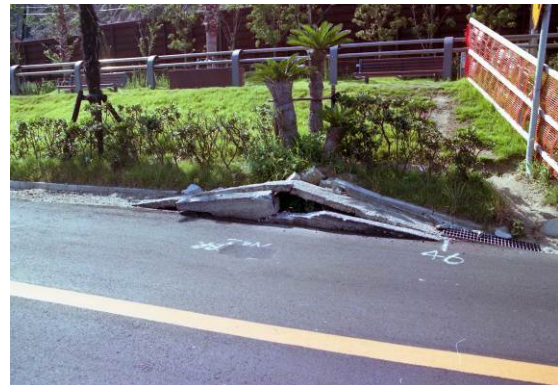
写真12 排水溝の蓋のプレッシャーリッジ（淡路島北淡町江崎灯台）
