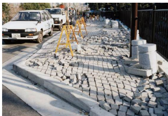
写真5 歩道の敷石の跳躍（宝塚市売布ヶ丘）
