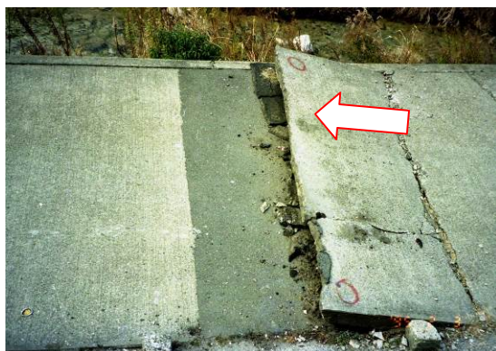
写真2 2つに分離したアスファルト舗装材で一方が他方に乗り上げる（住吉霊園 住吉台の北）
