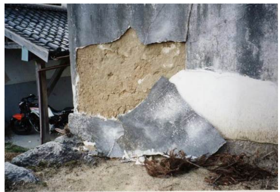
写真 24 土壁の漆喰の剥離（池田市）
