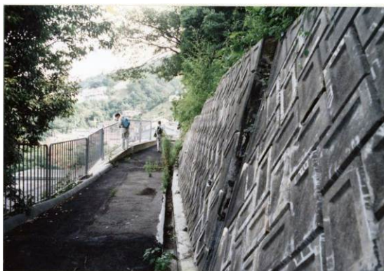
写真13 目地の部分で分離・傾動したブロック積み擁壁（宝塚市宝生ヶ丘）
