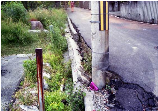
写真8 三面張り側溝の側壁の傾動（西宮市高塚町10丁目）
