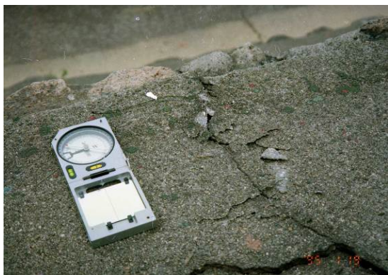
写真1 コンクリート舗装材に生じた衝突型の圧縮構造（大阪鞠公園） 開口クラックが次の揺れで閉じたときに衝突し、一部が剥がれて山形に盛り上がった。
