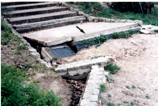
写真 21 階段下の踊り場の床張りコンクリート板の押しかぶせ構造（西宮市高塚公園） その際、排水溝に押された地盤は盛り上がり、縁石は「く」の字に折れ曲がった。
