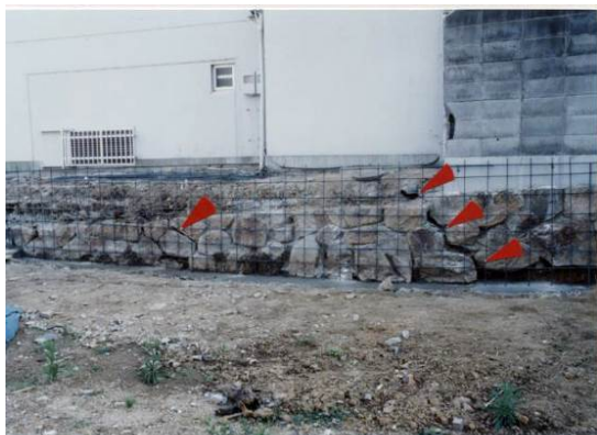
写真 25 空石積み擁壁に現れた低角度衝上に因る破壊
