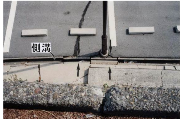
写真10 U字溝の破壊を伴う側壁の傾動
