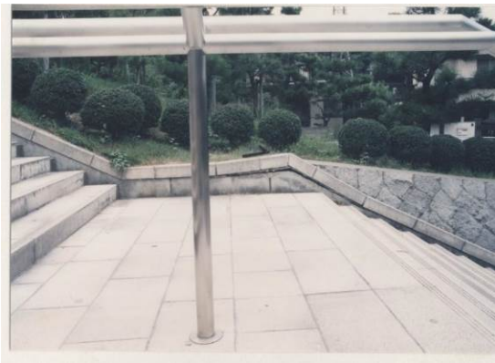
写真 20 階段通路の破壊タイプb（神戸大学）
