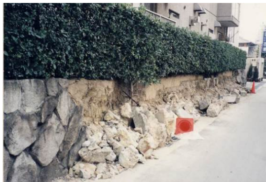
写真17 積んである自然石のほとんどが道路に跳び散った後の空石積み擁壁（神戸市東灘区） 自然石が崩れ去っても背後の盛土はほとんど崩れていないのが特徴である。
