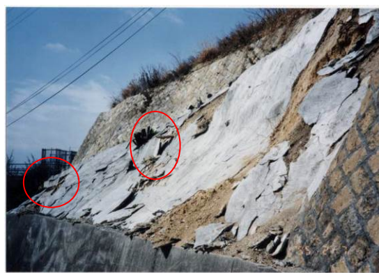
写真18 コンクリート吹付の剥離（神戸市東灘区岡本） 個々の地盤は風化花崗岩の破碎帯である。赤丸印は山形構造を示す。
