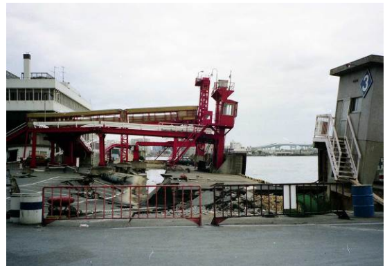
写真 23 ケーソン背後の陥没（青木港フェリー乗り場） 陥没したところに海水が流れ込んだ。
