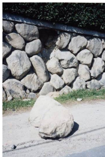
写真16 空石積み擁壁からの自然石の跳び出し（神戸市東灘区）
