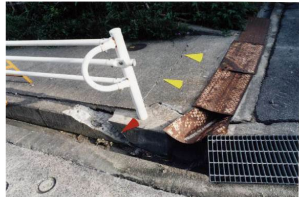
写真11 U字溝の破壊・傾動に伴う鉄の蓋の折れ曲がり 地形変換点（写真の右側が登り坂）で三面張り側溝は低角度衝突で破壊している。
