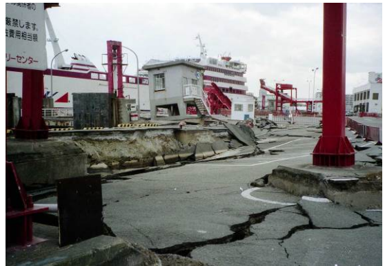
写真 22 ケーソン背後の沈下（青木港フェリー乗り場）
