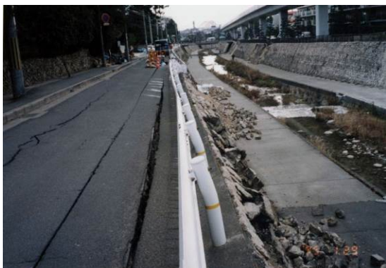
写真14 石積み擁壁の変状と地表断層の産状（東灘区魚崎北町4丁目の住吉川沿い、横山ほか、1997） 石積のはらみ出しでガードレールは道路側に傾いている。
