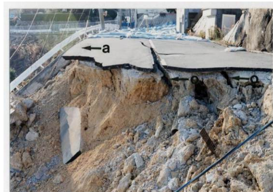
写真 28 西岡本地すべり（神戸市東灘区、横山・菊山、1998） アスファルトの移動と共に盛土の上部は斜面側にたわみ（aの矢印）、深部には伸びていない開口クラックも斜面側に変位している。
