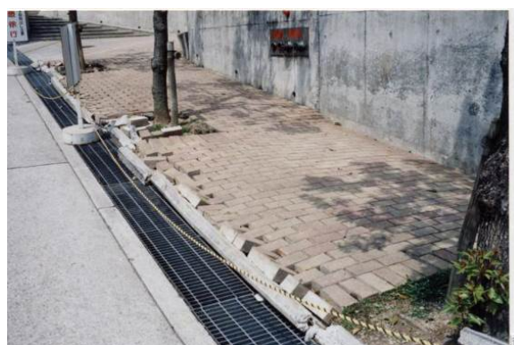
写真6 道路歩道の縁石の傾動・転倒（芦屋市旭ヶ丘） 縁石の上に歩道の煉瓦も乗り上げている。
