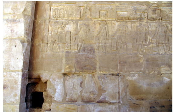
写真 15 門の内部の壁画、修復作業跡がみられる。
