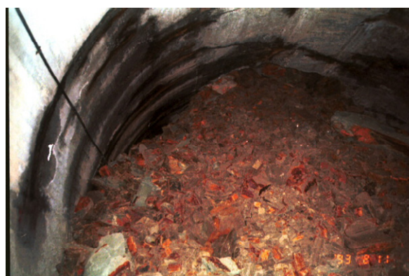
図4 1993年能登半島沖地震におけるトンネル被害例(金沢大 河野・石渡 被害状況調査報告より)
